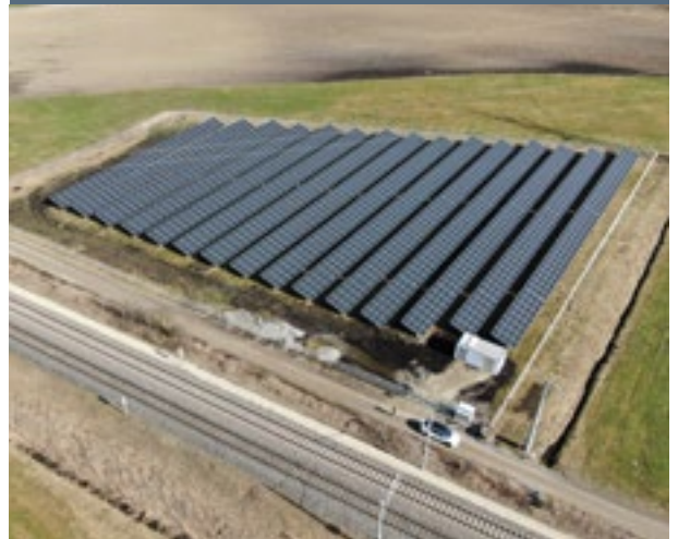
Freiland Anlage | Bad Schussenried 749 kWp
